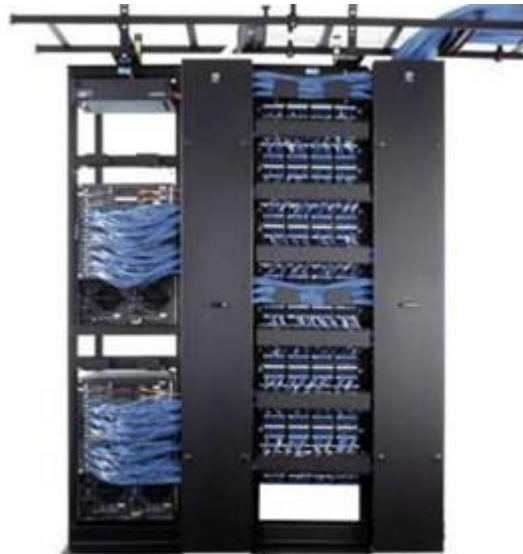
RACK PARA SISTEMA DE CABLEADO
